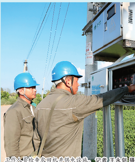
工作人员检查农田机井供电设施。记者 王永剑摄
